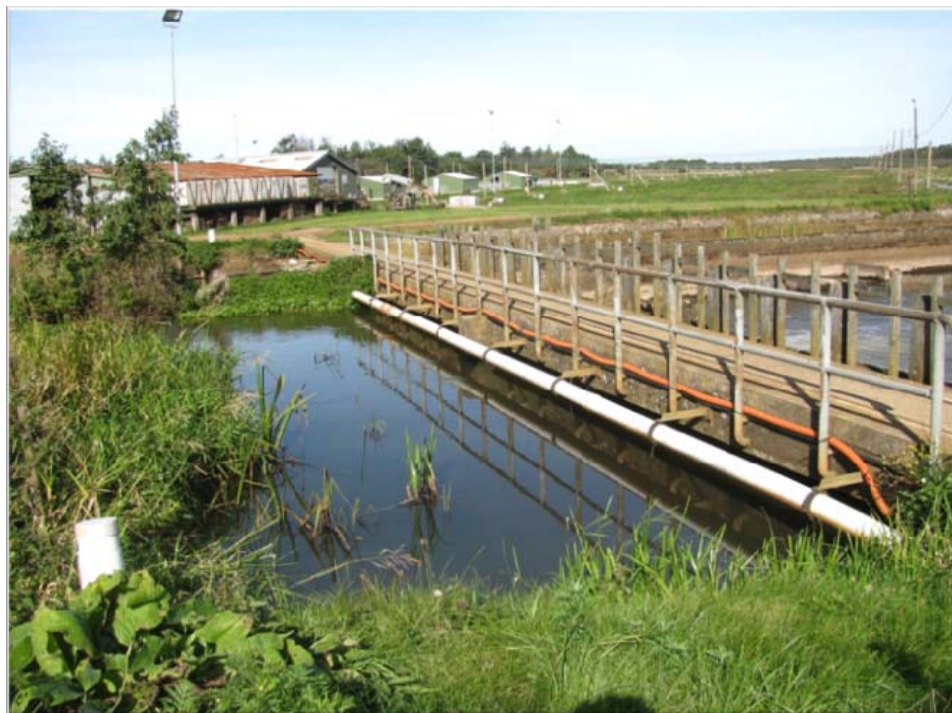
Figur 2.2.3: Rør ved stemmeværket, der udleder vand pumpet fra fældningsbassinet
