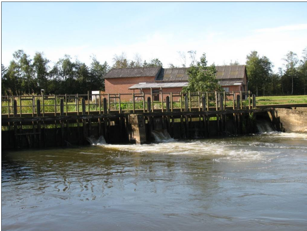
Figur 1.1.1: Stemmeværket ved Gelsbro Dambrug. Til højre skimtes betonvæggen til den eksisterende faunapassage (kammertrappe med dykket indløb).
